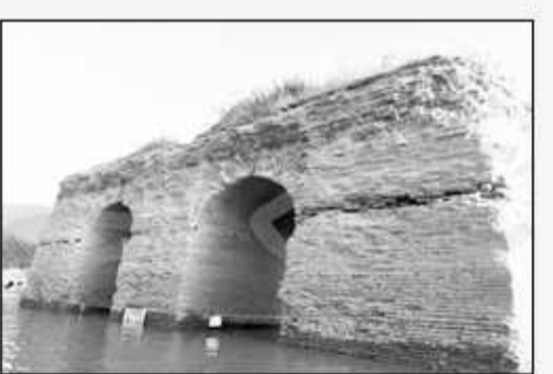
ضلع شمالی چهار طاقی آجری کاخ تابستانه شاه عباس که بیشتر از سایر نقاط در معرض امواج آب و باد است در معرض تخریب قرار گرفت. سرپرست پایگاه میراث جهانی باغ عباس آباد با بیان اینکه خسارت به یک لایه از چهار طاقی آجری عباس آباد عمیق نیست، گفت: این خسارت در ضلع شمالی این چهارطاقی که بیشتر از سایر نقاط در معرض امواج آب و باد است اتفاق افتاده و بخشی از یک لایه آجر به
